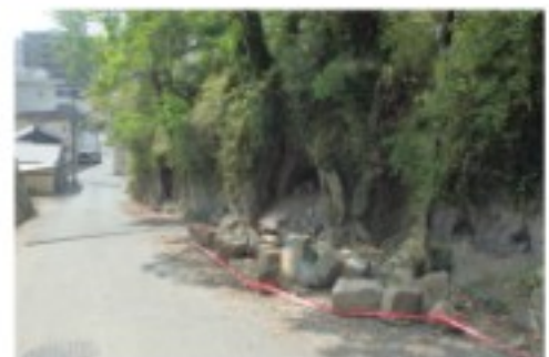
正門入り口付近の菜師坂の崖崩れ現場。
